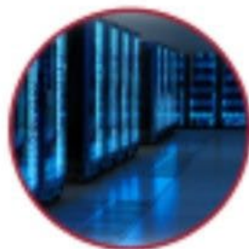
Fast AI: Data Center & Edge Computing
